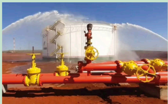
Simulado de atuação do sistema de combate a incêndio nos tanques de etanol, na Usina da Pedra.
