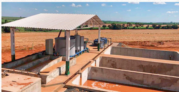
Detalhe da caixa separadora de resíduos (caixa SAO), da ETEA.
